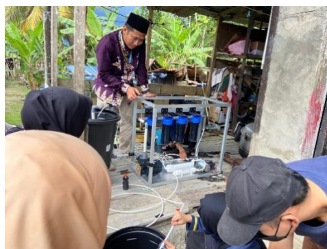
Gambar 4. Proses praktek kerja alat sistem pengolahan limbah cair batik
